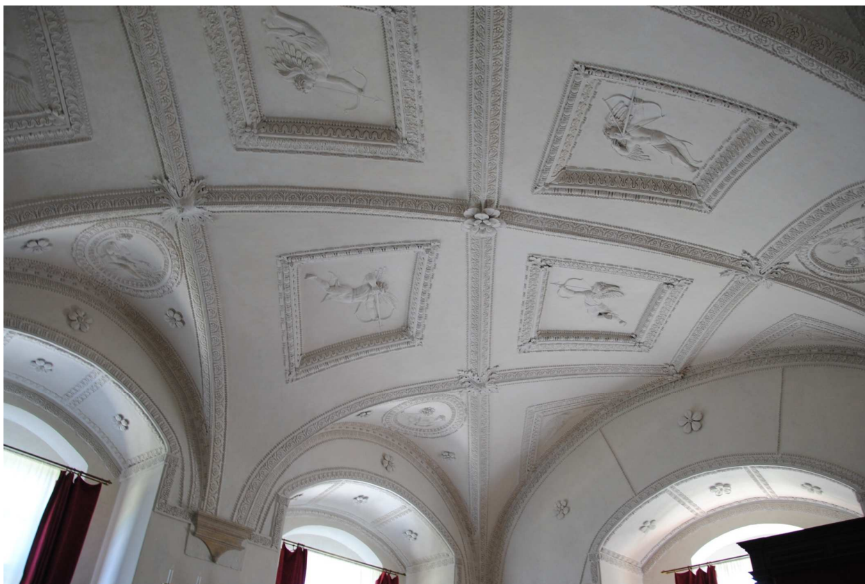
147. Antonio z Melana, Pohled na štukovou dekoraci klenby ložnice Polyxeny Pernštejnské z Rožmberka, kolem 1590.
